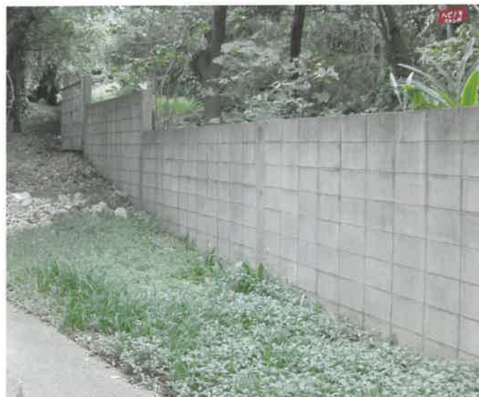
ハブの侵入を防ぐブロックべい
